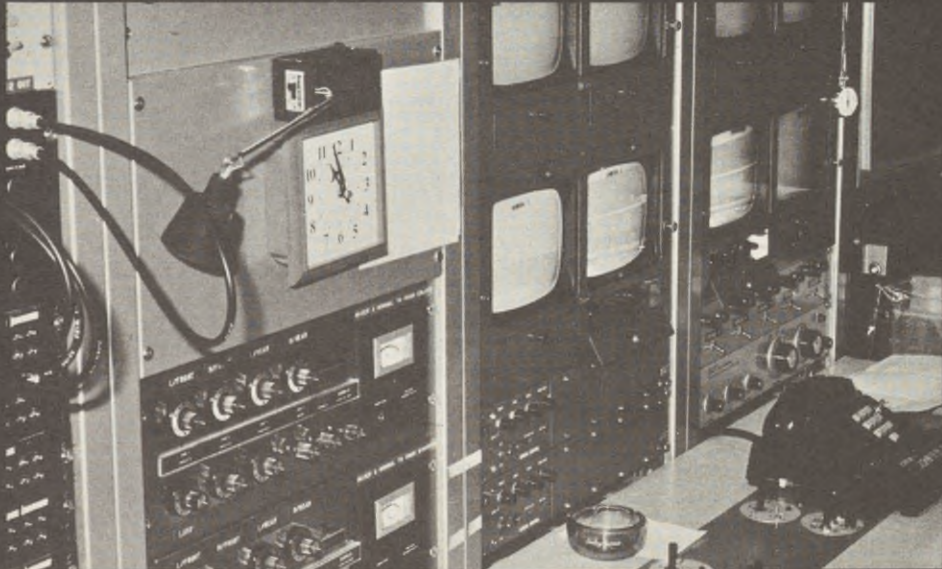
25. AV INSTRUCTIONAL EQUIPMENT CONTROL CENTER.
